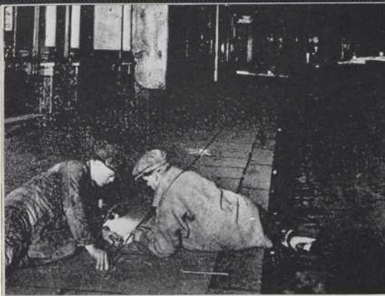
Construction de la section "Morden" de la ligne Northern, à Londres, en 1926. A gauche, alors que la population dort, des techniciens tracent sur les trottoirs l'endroit exact où passera, en-dessous, la ligne médiane de chacun des deux tunnels parallèles dans lesquels le métro circulera.
