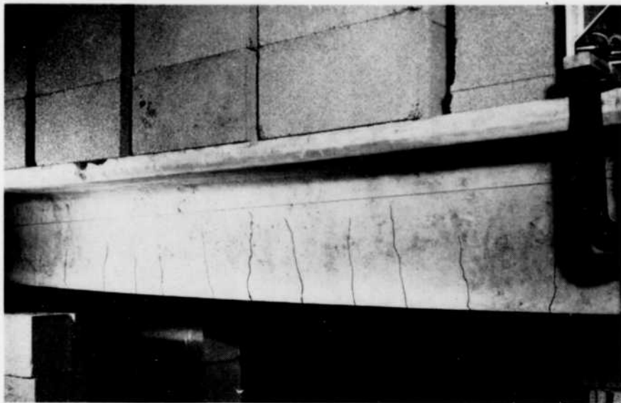
Fig. 4 — Vue du centre de la portée montrant les fissures caractéristiques qui se sont développées lorsque la dalle fut chargée à la charge ultime minimum recommandée. (La corde indique la ligne de niveau).
