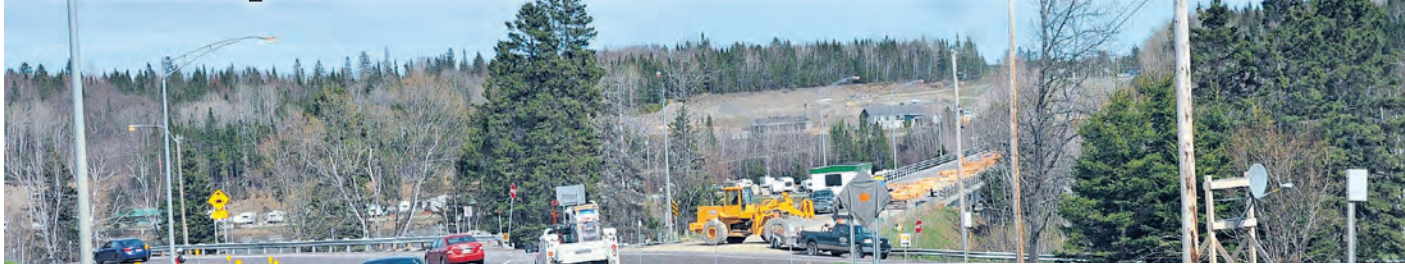
Les travaux achèvent sur le gros chantier du pont de la rivière Cascapédia.
