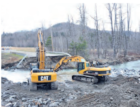
Deux grues sont à l'œuvre présentement afin de nettoyer le lit de la rivière à cet endroit afin de reconstruire le pont.
