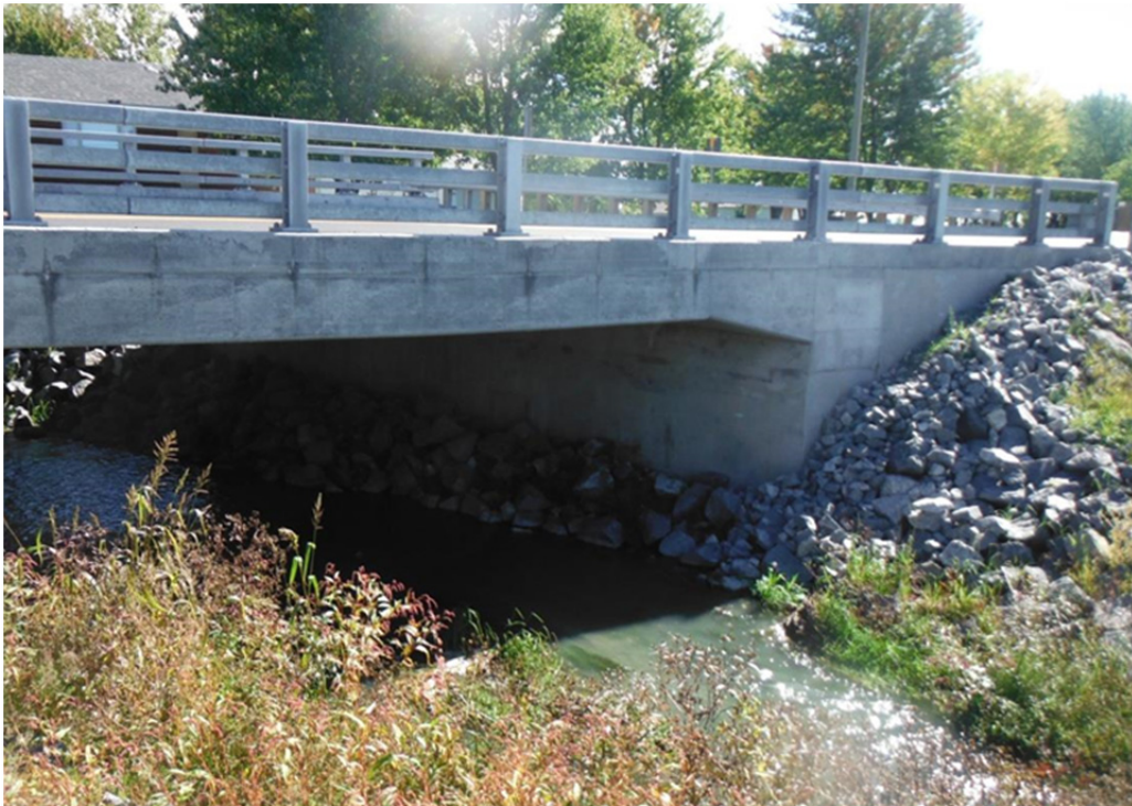
Figure 1 Exemple d'enrochement réalisé pour protéger un pont (17536)
