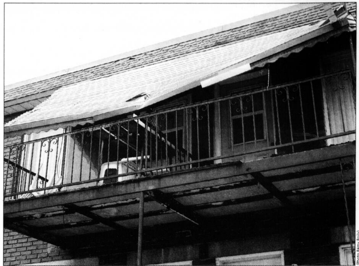
Le toit de tôle de la galerie a été arraché lors d'une tempête de vent, il y a quelques semaines.
