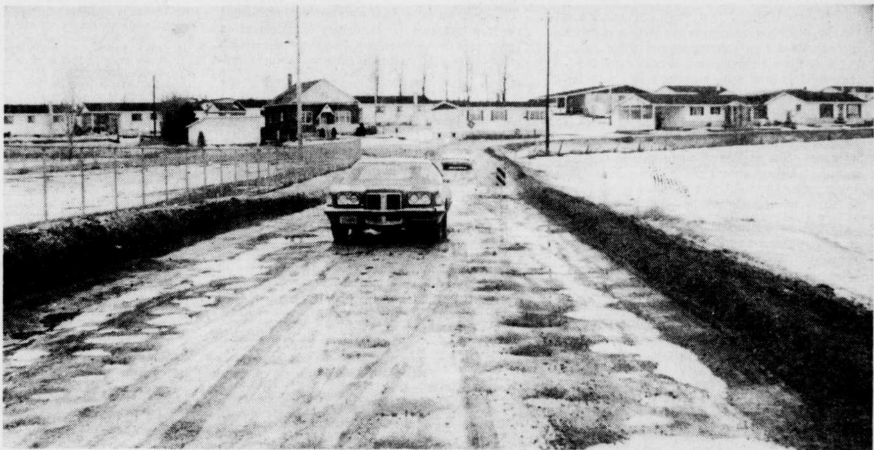
Les profondes cavités de la rue "24 juin" entre le cimetière Saint-Michel et le développement Dubreuil, ont nécessité la mise en place de panneaux balisés pour mettre en garde les automobilistes. (Photo La Tribune, Royal Roy)
