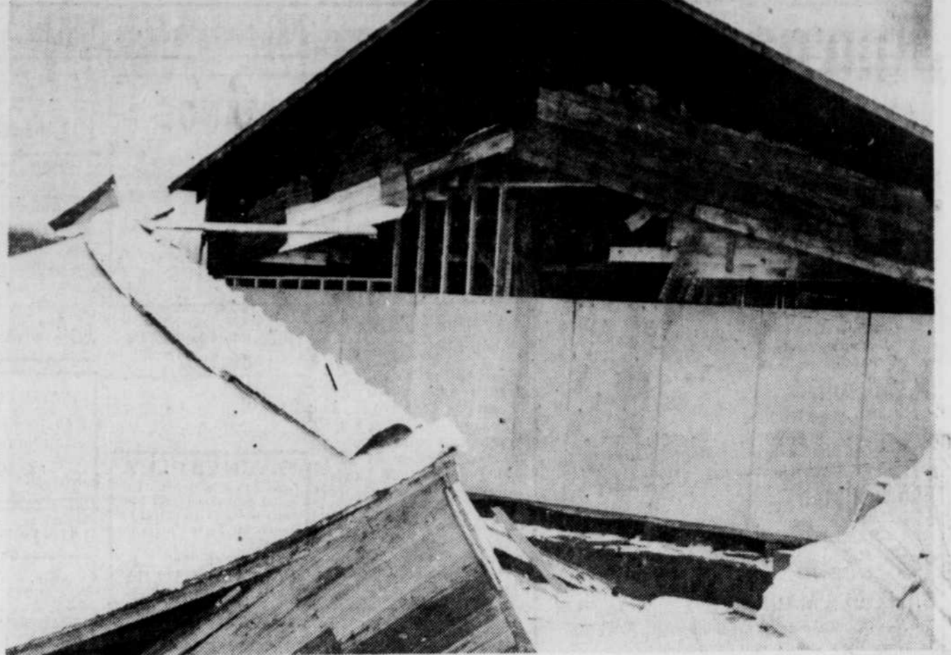
Voilà tout ce qui reste de l'un des entrepôts de la compagnie "Les croustilles Yum-Yum" que les glaces ont jeté par terre sur leur passage. (Photo La Tribune, Warwick, Serge Beucher)
