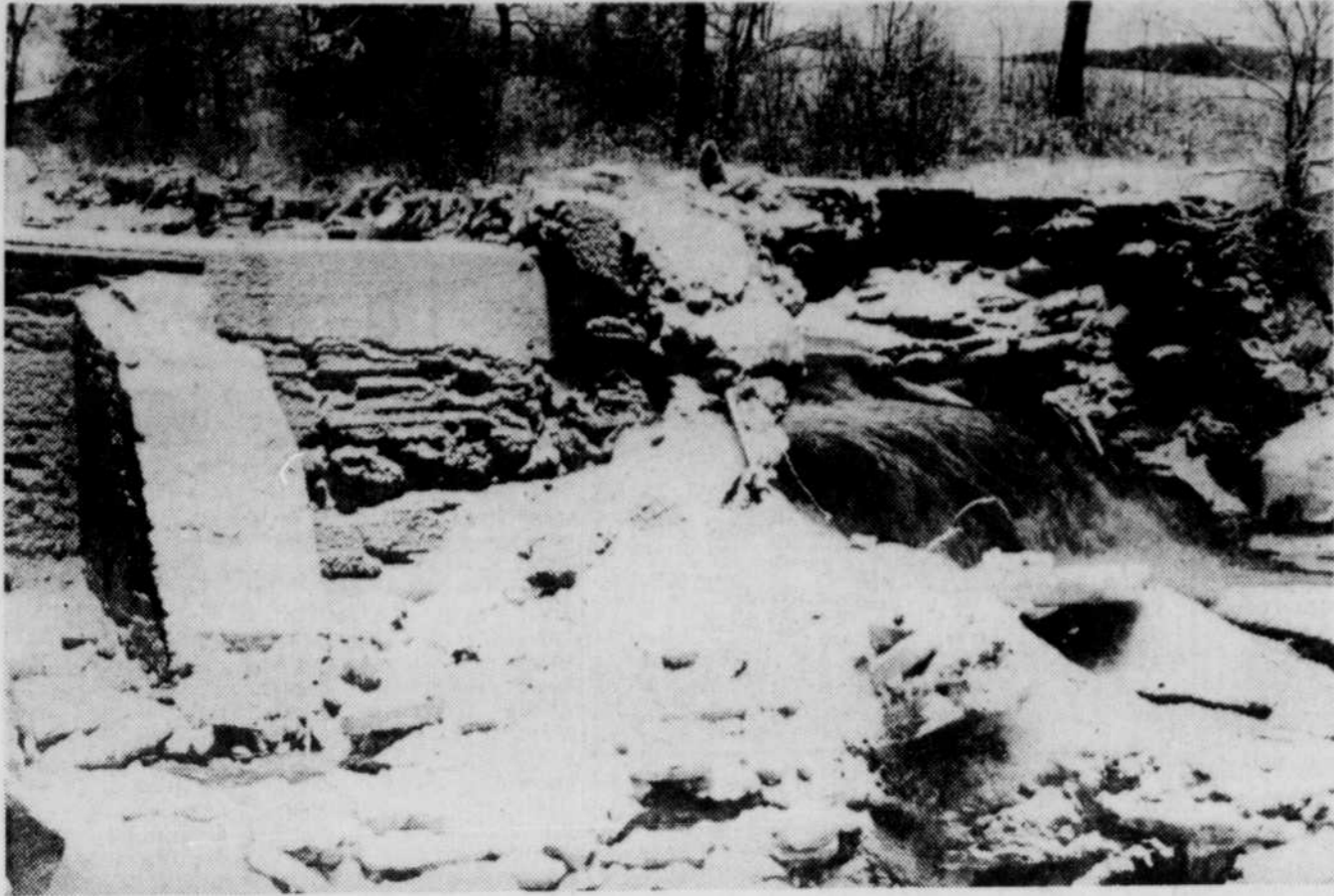
C'est ce barrage désuet, en partie défoncé, et qui devrait être démolit depuis longtemps, qui a causé pour plusieurs milliers de dollars de dégâts au pont chez Daigle et à l'entrepôt des "croustilles Yum-Yum" sur la rue Du Moulin alors que les glaces de la rivière Des Pins ont tout saccagé. (Photo La Tribune, Warwick, Serge Beucher)
