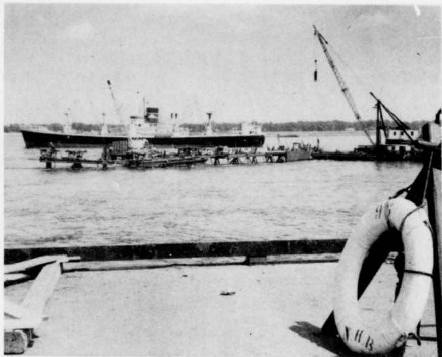
Fig. 2 — Vu du quai Laurier, le déflecteur en cours de construction. Il fut ancré au fond du fleuve par des câbles tendus à 50,000 lbs. à l'intérieur des tuyaux de la structure. A droite, le ponton-grue battant les palplanches. Vers la gauche, la grue chargée de récupérer la cargaison.
