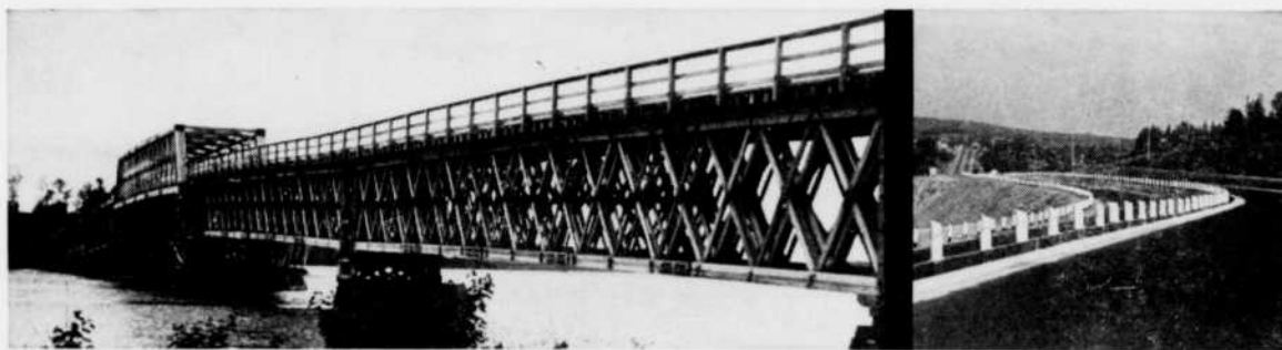
Pont traité à l'OSMOSE en 1940 et encore en usage
