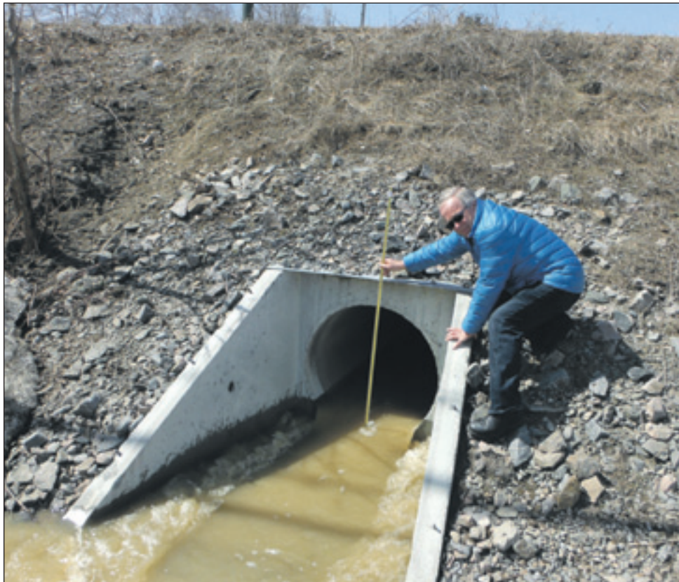
M. Alain Juneau, administrateur au CBLSA, mesure la hauteur libre d'écoulement de l'eau.
