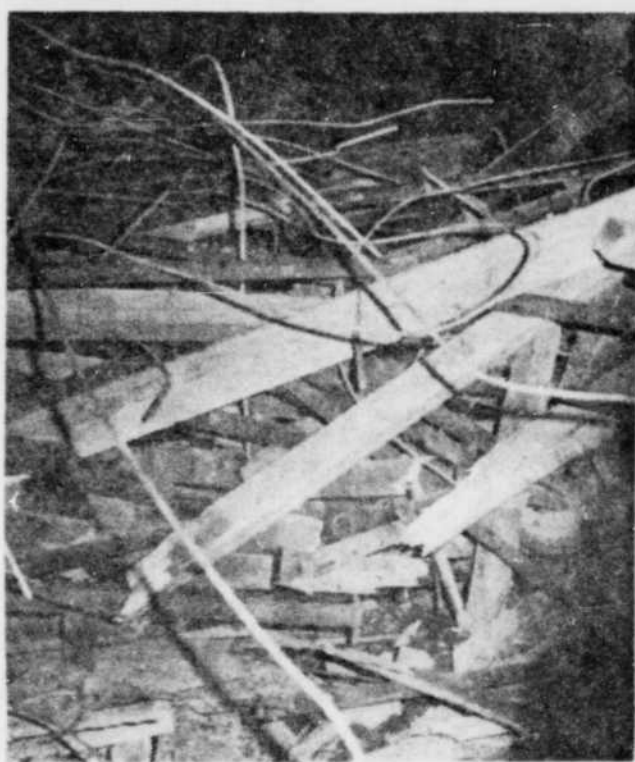
C'est sous ces débris que l'on aperçut la main de celui qui perdit tragiquement la vie à la suite de l'effondrement du toit de la bâtisse du Centre Civique en construction.
