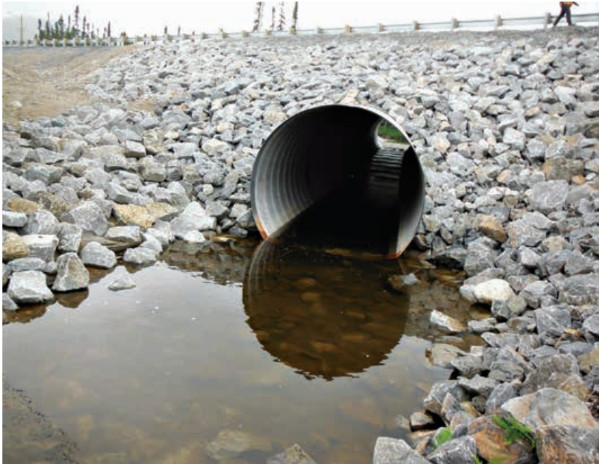
Ponceau muni de déflecteurs pour faciliter le passage des poissons, au kilomètre 115,2 de la route de la Romaine
