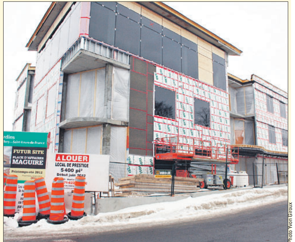
L'avancement des travaux est perceptible pour les passants. Jusqu'à maintenant l'échéancier des travaux est scrupuleusement respecté.
