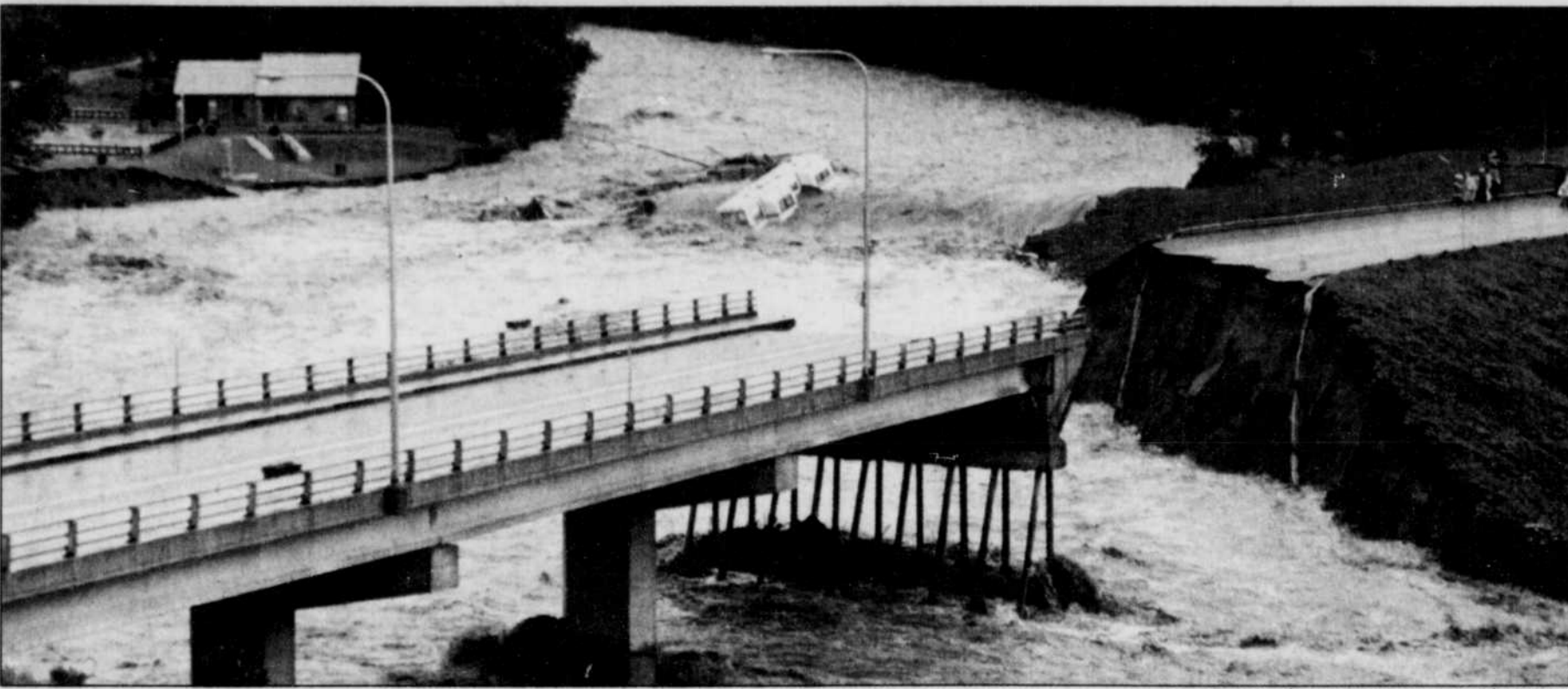
Une partie de ce pont, situé à ville de la Baie, au Saguenay, a été emporté par les eaux.
