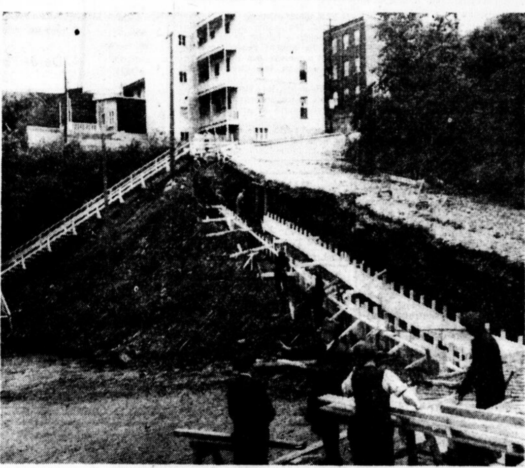
La côte Badelard, surnommée la côte de la négresse, sera réouverte à la circulation lorsque les travaux de réfection seront terminés. Comme on le voit, des ouvriers construisent des formes en bordure de cette côte pour y couler un mur de soutènement. Elle avait été fermée par suite de son état dangereux causé par l'effritement de ses appuis. (Photo de "L'Événement-Journal")
