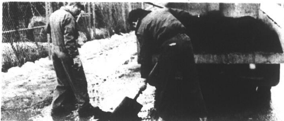
Les politiciens ont indiqué que le service des Travaux publics devra revoir ses méthodes de compactage de l'asphalte.
