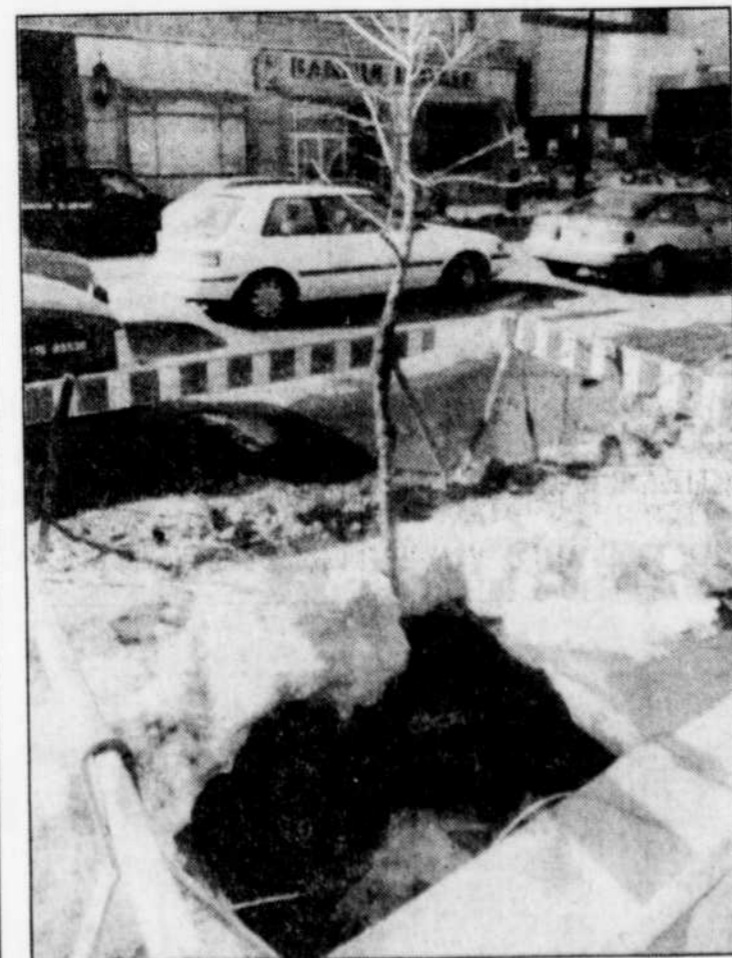
Une employée de la banque a constaté que le sol du trottoir devant l'entrée située de la banque s'était affaissé et qu'un petit arbre était tombé au fond du trou.
