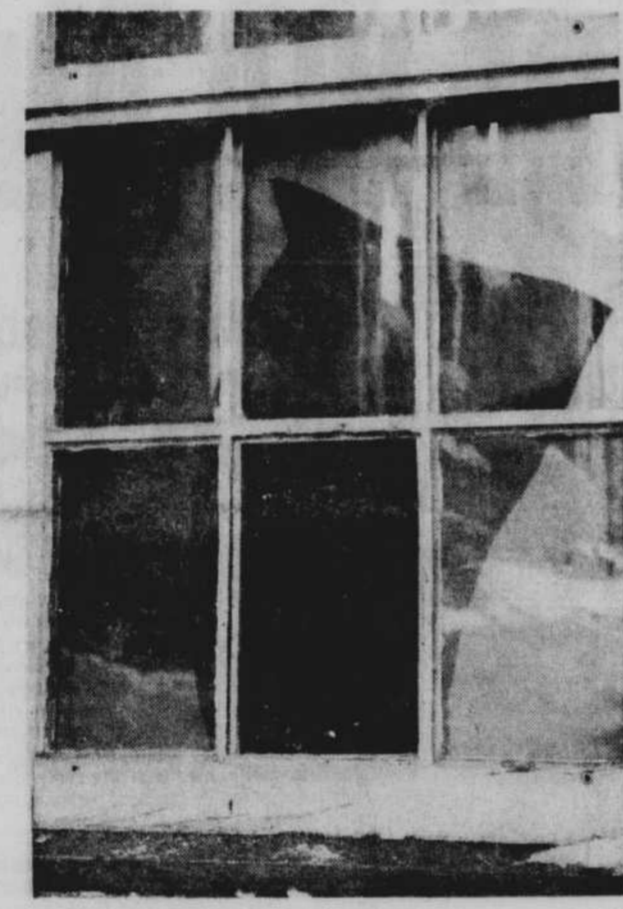
CARREAU DE LA FENÊTRE par lequel les voleurs ont pénétré à l'intérieur de la salle. Une grande vitre, derrière cette fenêtre extérieure, a également été fracassée.
