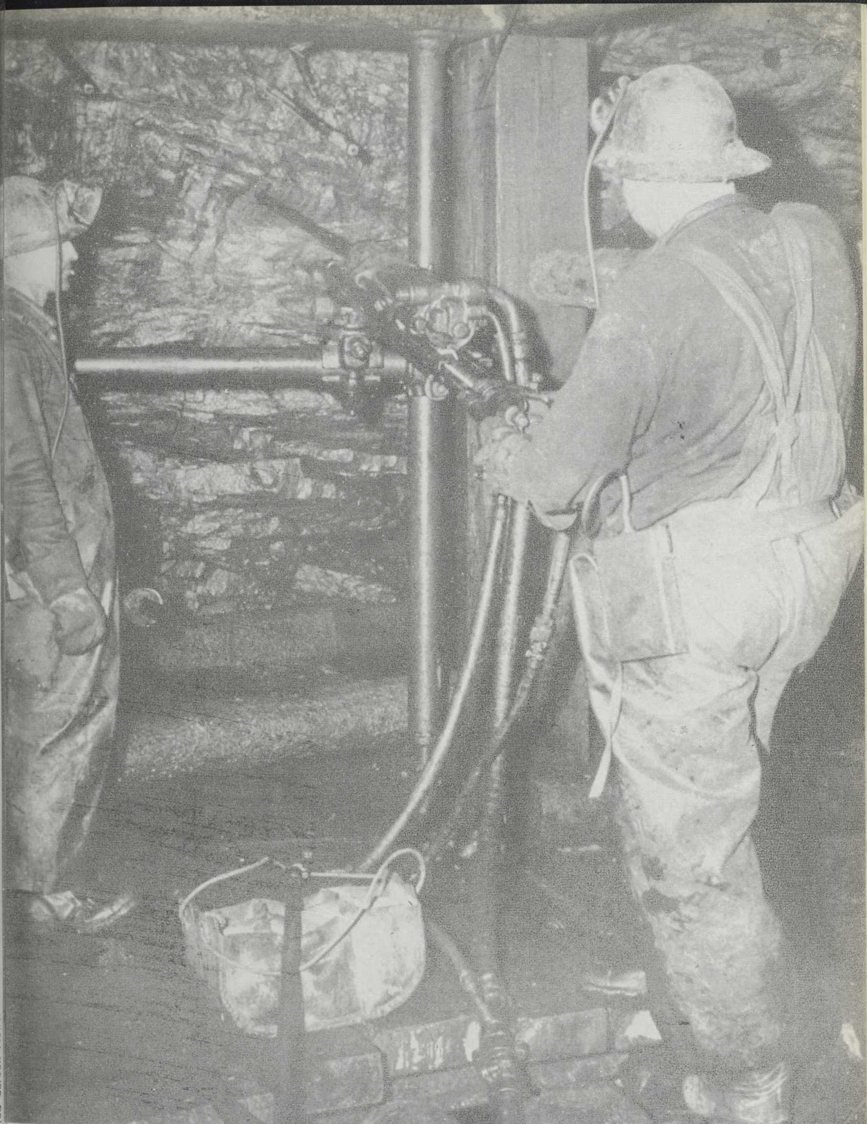
Forage de trous de mine dans un chantier d'abatage à boilage quadrillé dans la mine Normetal dans l'Ouest de Québec. Avec ce système d'exploitation, le toit et les parois de l'excavation sont soutenus par un ensemble de pièces de bois horizontales et verticales disposées en formes de cubes creux.
