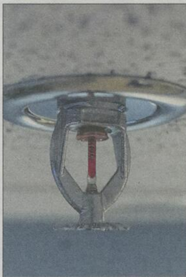
Seulement cinq résidences privées à Saint-Jean-sur-Richelieu sont munies en totalité de gicleurs et trois le sont partiellement.
