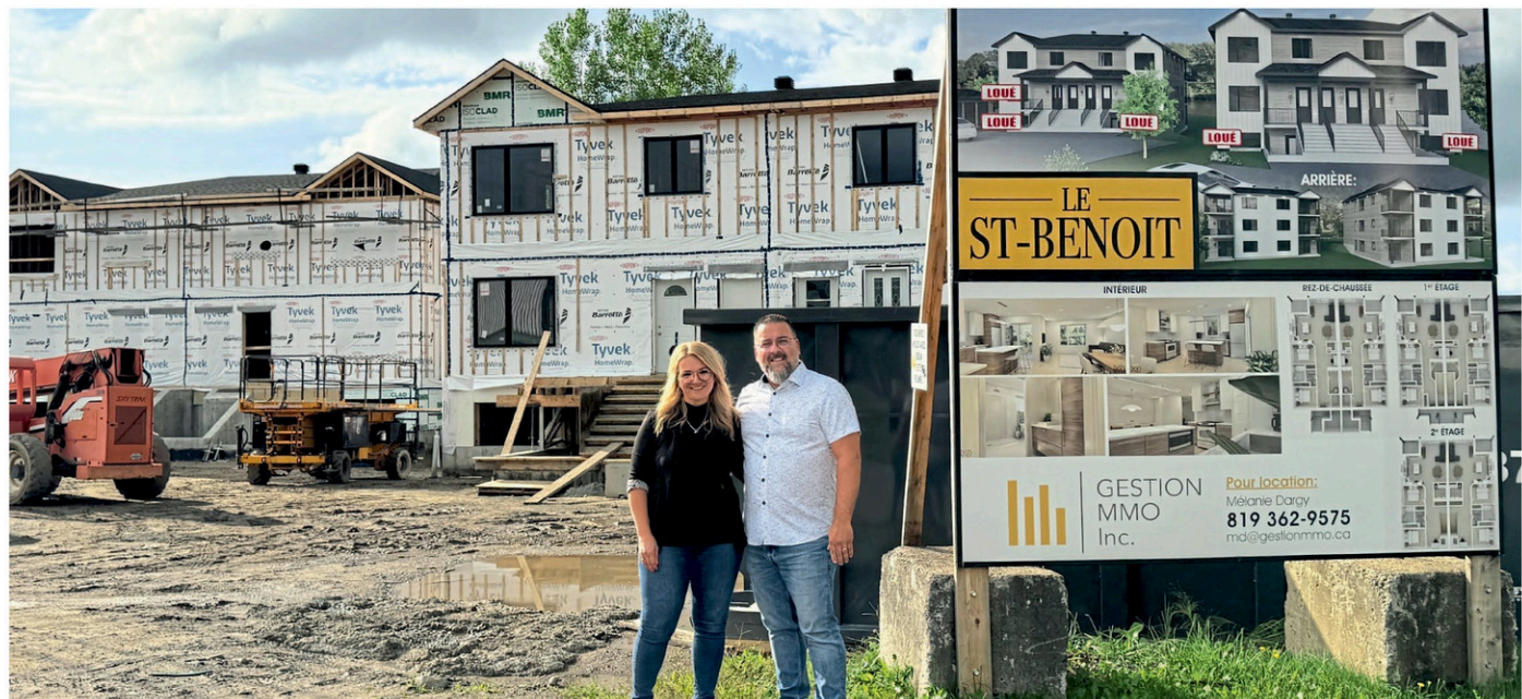
Les promoteurs, Mélanie Dargy et Jean-François Beaudoin, sont fiers de contribuer au développement de leur ville par la construction de ces deux immeubles à six logements sur la rue Saint-Benoît au coin de l'avenue des Érables. (Photo gracieuseté)
