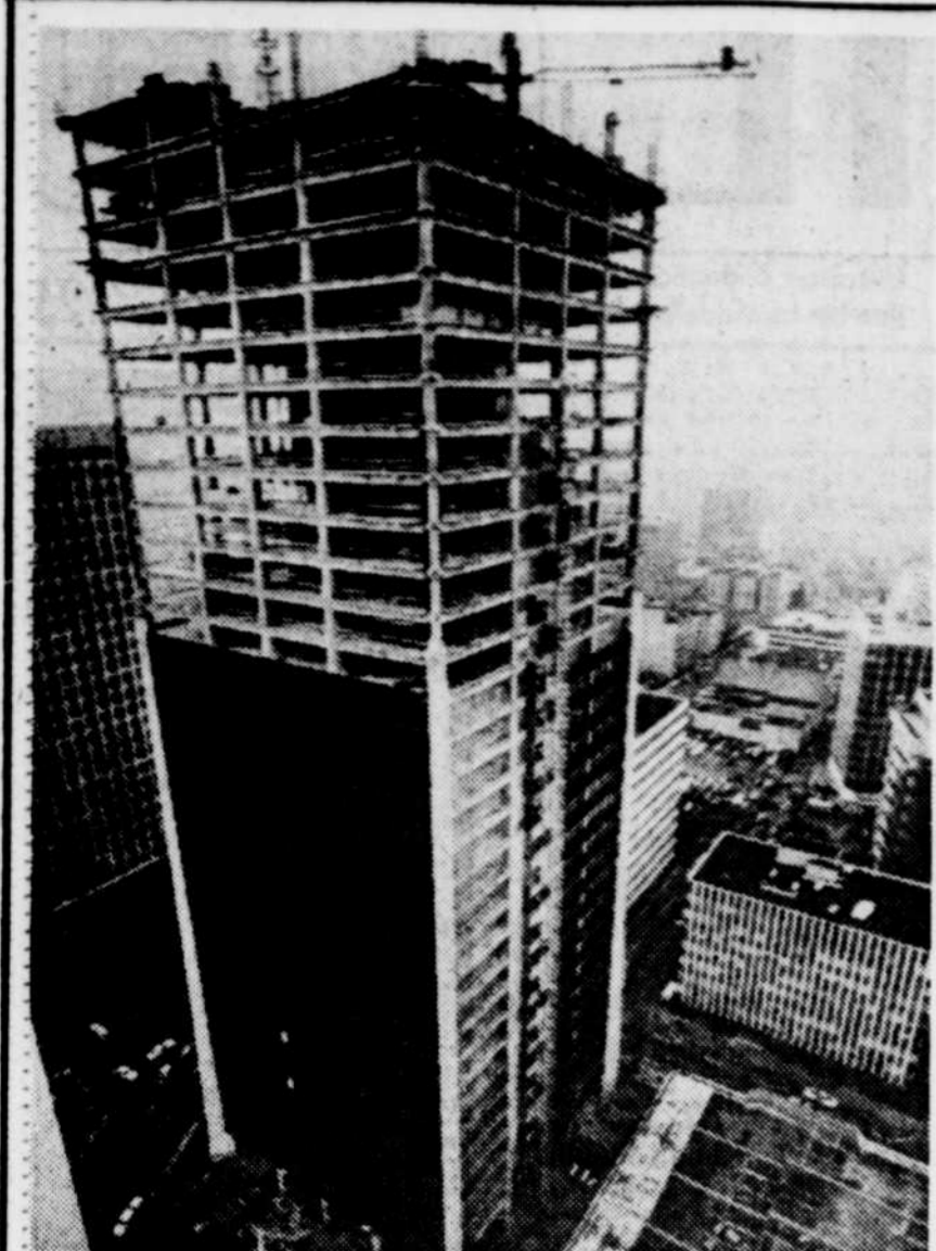
Quatre ouvriers ont fait une chute à partir du 36e étage d'un édifice en construction, à Vancouver, à la suite de l'effondrement d'un échafaudage.
