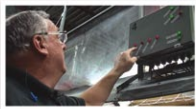
TC TRANSCONTINENTAL QUALIMAX Mesures pour sécuriser un équipement et assurer la permanence des correctifs.
