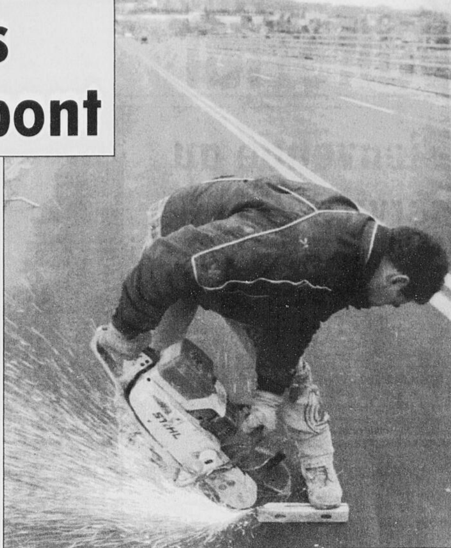
Comme tous ses collègues de travail qui ont eu à rajeunir le pont Jacques-Cartier, Sylvain Bouchard a quitté le chantier en fin d'après-midi, hier.
