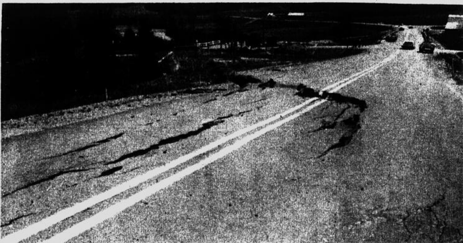
3 JUIN: l'affaissement de la route secondaire reliant Lac-Drolet à St-Ludger.
