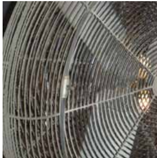
Ventilateur de recirculation de l'air sur lequel est installé un système de brumisation dont on voit ici une buse
