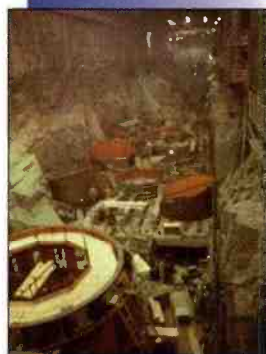
LG2 Salle des machines Février 1978
