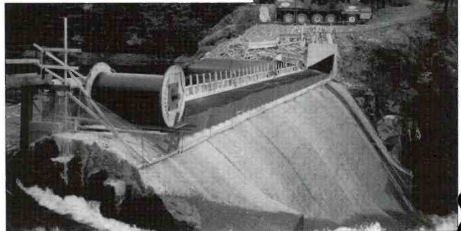
Septembre 1998. Installation d'une vanne gonflable au barrage Chute Bell. Hydro-Québec, région Laurentide (rivière Rouge). 1,40m X 60,00m.
