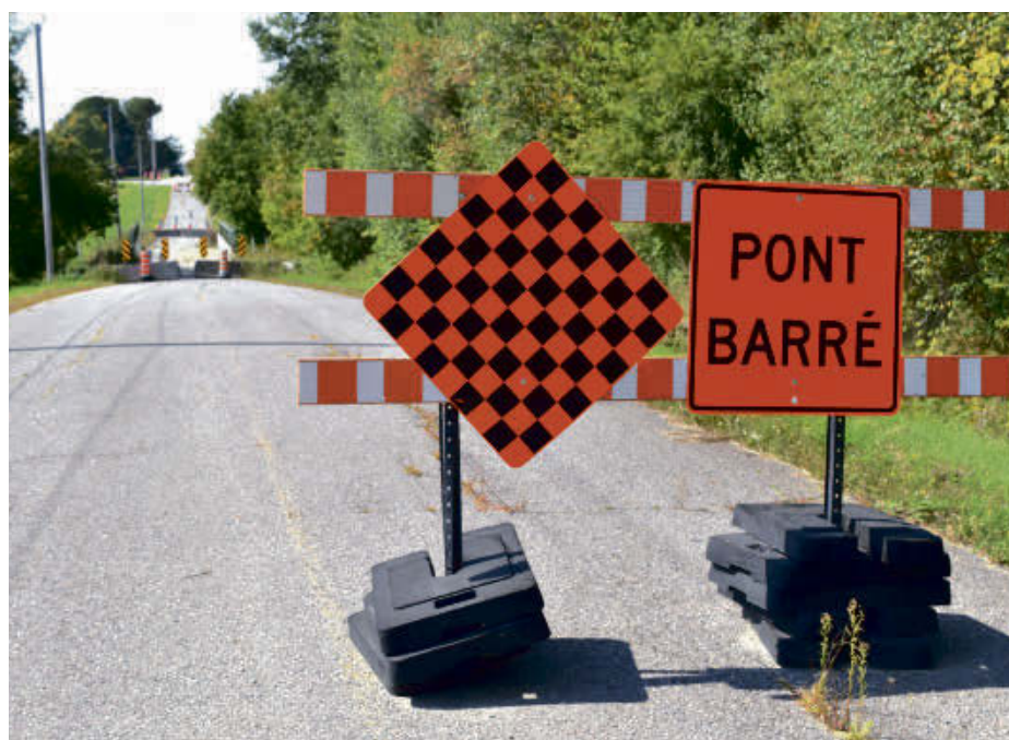
Le pont du 5 e Rang, qui enjambe la rivière Le Renne à Saint-Théodore-d'Acton, est fermé depuis mars 2016. Sa réouverture est prévue vers 2020.
