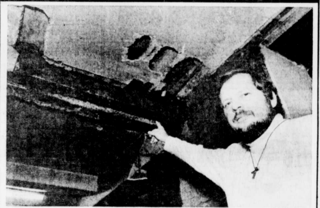
Le Soleil, René Mathieu Le curé de Saint-Roch, M. Pierre-André Fournier, montre une des fissures qui sont apparues dans l'église au moment des travaux d'excavation du stationnement souterrain de l'édifice à logements La Chancelière.
