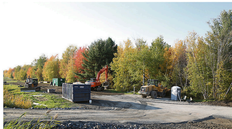
L'entrepreneur responsable des travaux exécutés pour Hydro-Québec le long du boulevard Pierre-Laporte à Bromont a respecté les demandes de la MRC pour contrôler l'érosion, soutient la société d'État. — PHOTO JULIE CATUDAL
