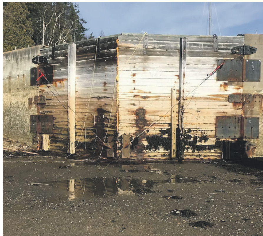
Les portes de la cale sèche sont en fin de vie. Photo Tides of Tadoussac
