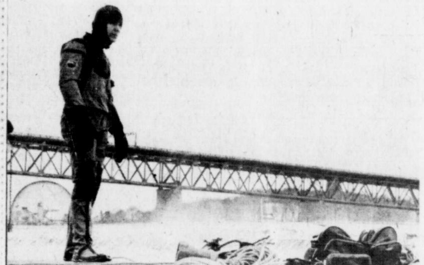
Un des plongeurs qui a été appelé par la ville de Longueuil pour faire fondre le frasil qui se trouvait dans la conduite d'amenée d'eau brute, attend de recevoir les ordres de son patron avant de pénétrer dans le puits.
