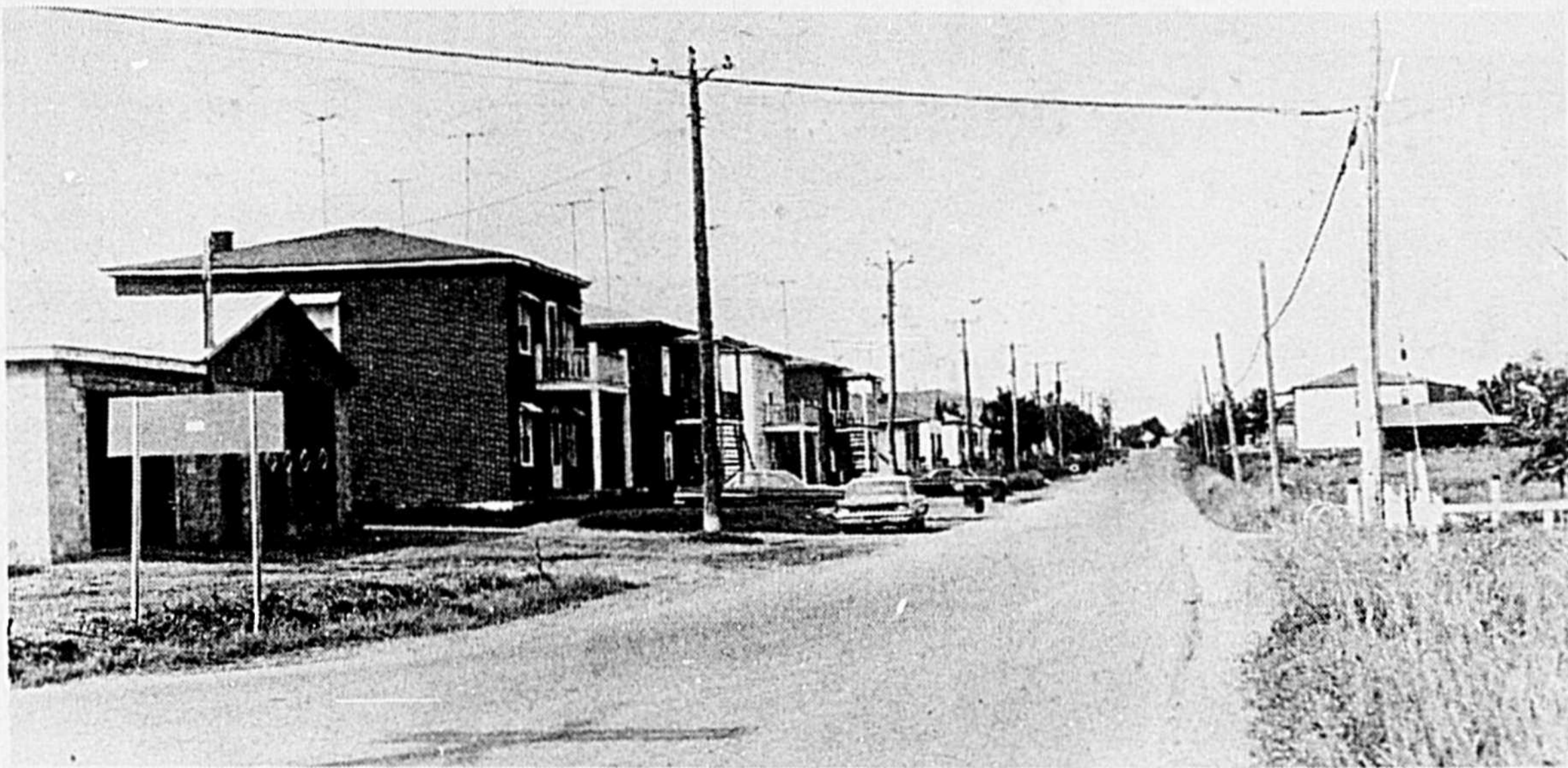
Cette section de la rue de Lanaudière, dans la municipalité de Saint-Paul sera bientôt dotée de services d'aqueduc et d'égoût. Les travaux sont décrétés et seront réalisés grâce à une subvention du gouvernement provincial.
