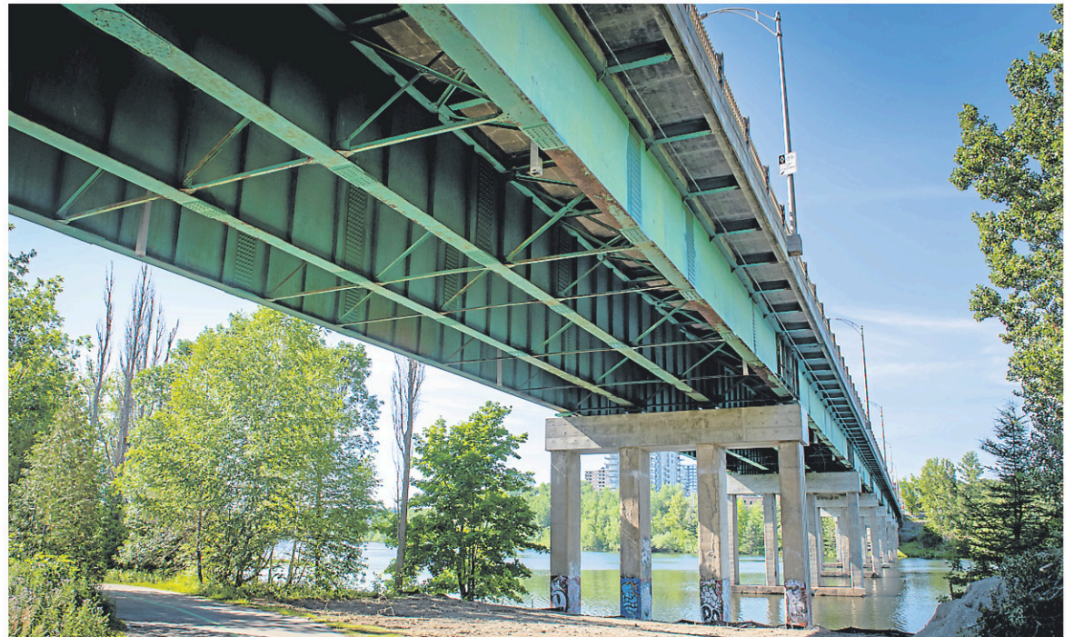
Des travaux commenceront jeudi sous le pont Jacques-Cartier. — PHOTO SPECTRE MÉDIA, ANDRÉ VUILLEMIN
