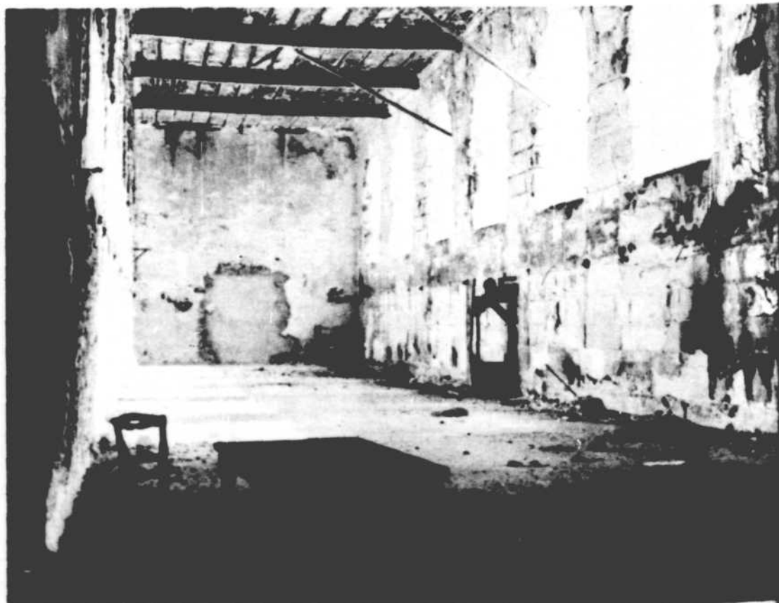
Ce qui reste de la salle de lecture de la bibliothèque de l'université d'Alger: 600.000 volumes ont été détruits.
