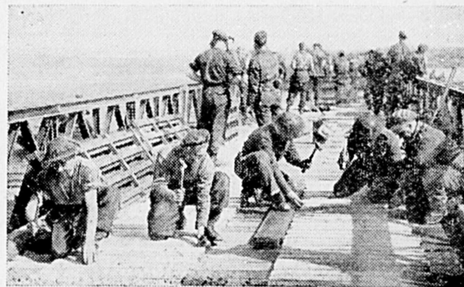
Des sapeurs britanniques, qui se sont entraînés sur les rivières du comté d'York, lancent le premier pont Bailey sur le Rhin. La photo a été prise pendant la pose de la dernière travée.
