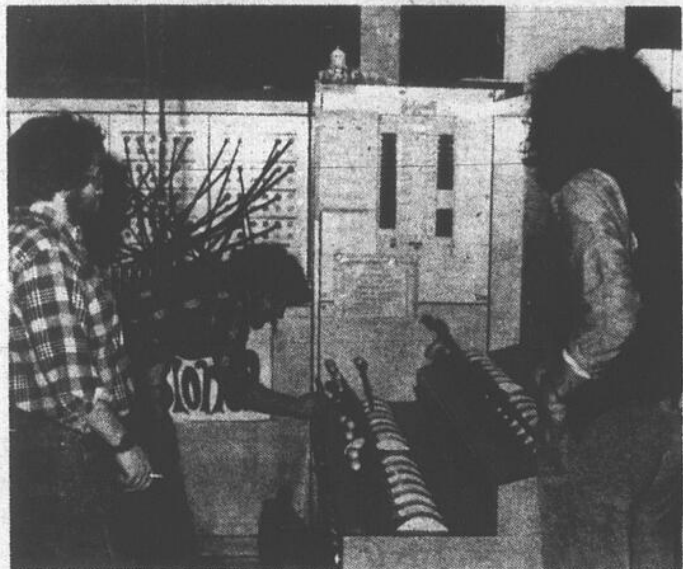
Le tableau d'éclairage, instrument complexe mais efficace.
