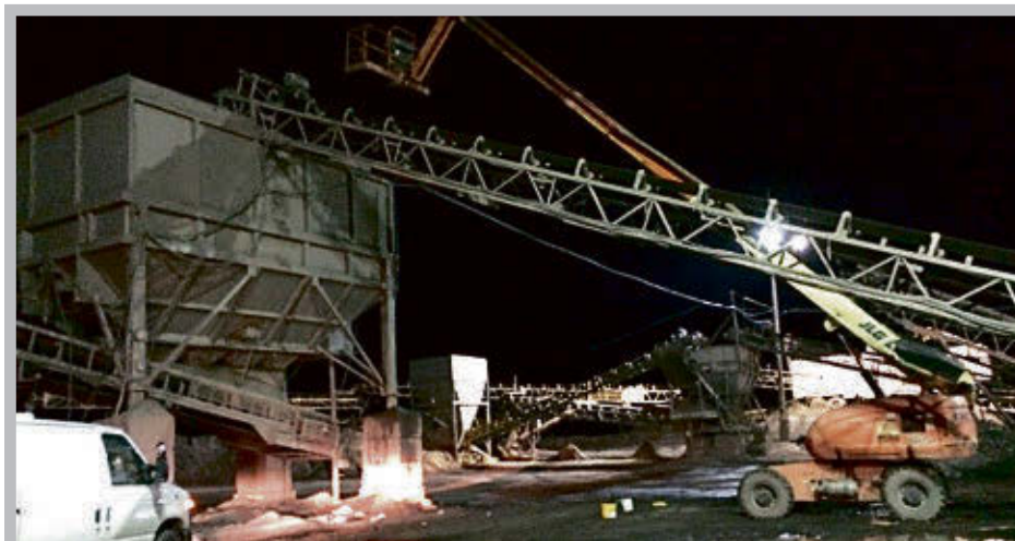
► Mathieu Mathieu-Pépin a chuté de cette plateforme élévatrice, le 22 octobre 2018.
