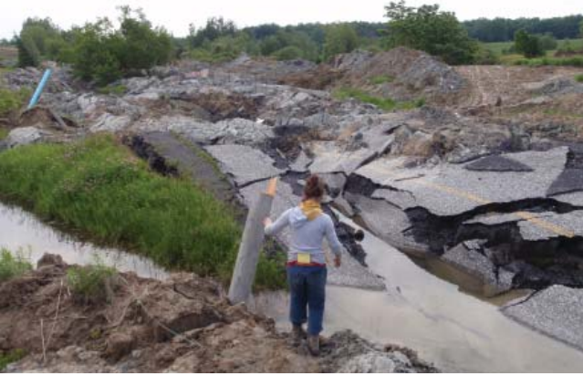
PHOTO 1 - Glissement de terrain de Saint-Jude survenu dans une séquence de rythmites marines silto-argileuses.
