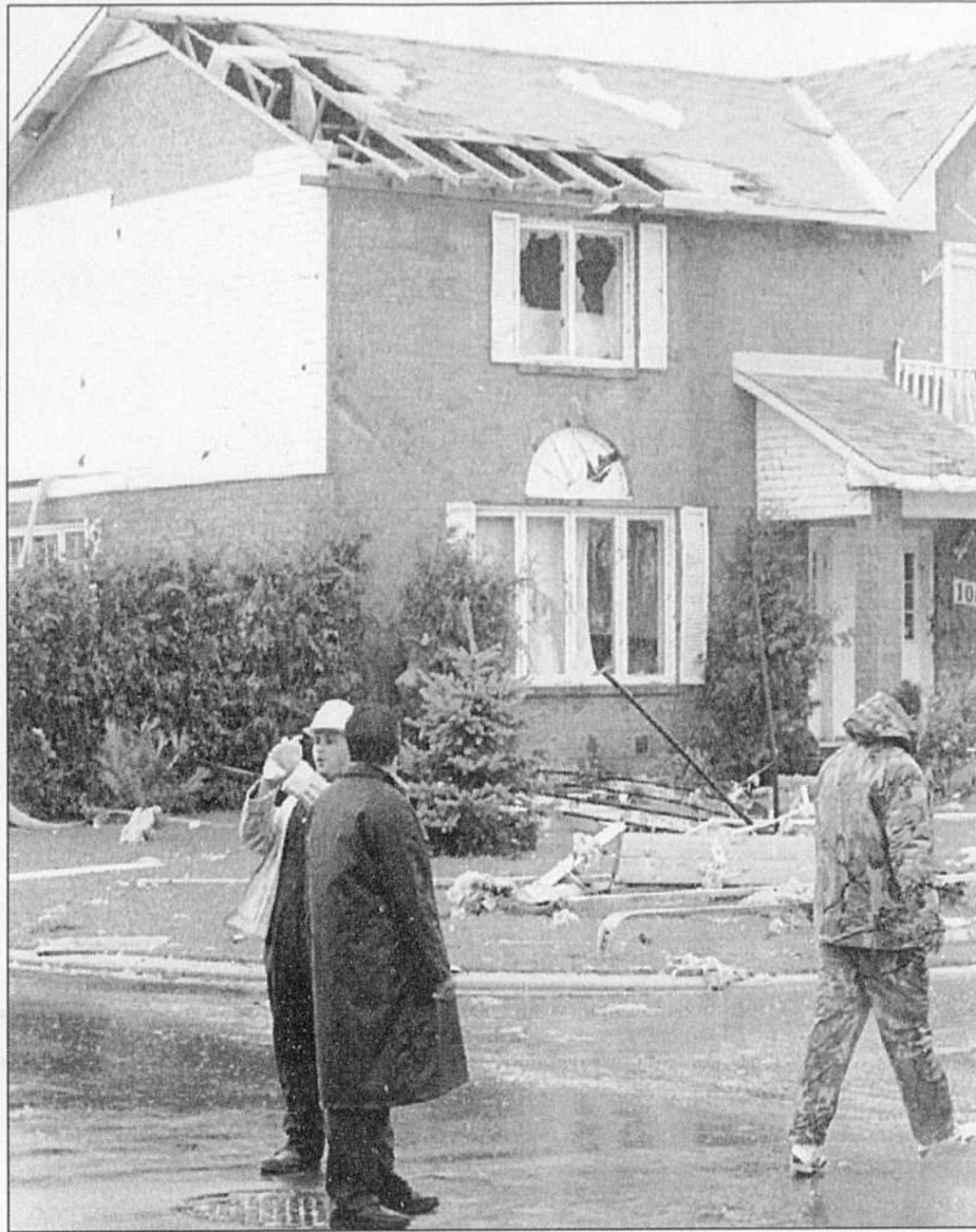
Au total, une cinquantaine de maisons ont été endommagées à Aylmer par la tornade qui n'a duré qu'une trentaine de secondes.
