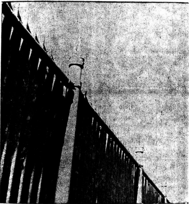
Une partie du mur qui entoure l'enceinte du monastère . . . Un insigne bienfaiteur s'est chargé de cette réparation, car la palissade de planches n'y tenait plus. L'horizon des Moniales n'est pas rétréci par ces frontières . . . les flèches pointent si joliment vers le ciel . . . Les sentinelles sont au poste . . . sous les armes !
