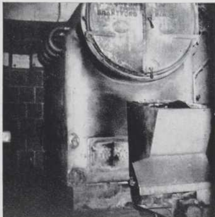
Vue de l'une des chaudières et du chauffeur automatique qui l'alimente.
