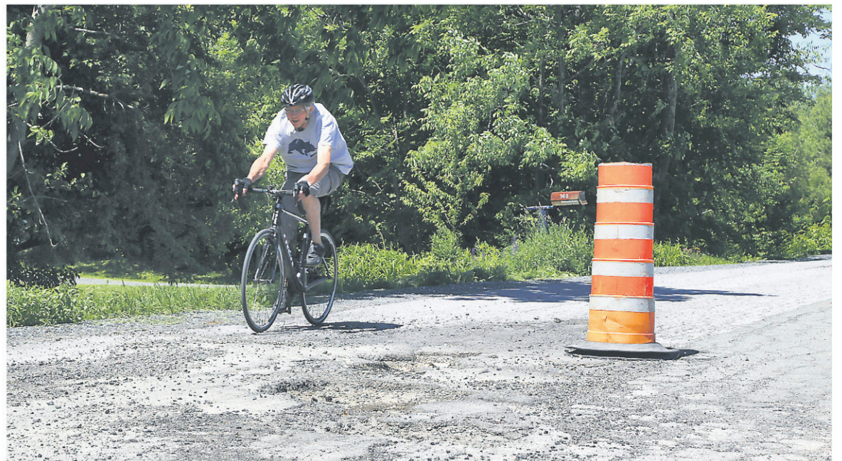
Plusieurs cyclistes passent par le poste frontalier de East Pinnacle pour se rendre au Vermont, souligne le maire Jean Lévesque. «C'est assez gênant de voir l'état de l'asphalte où ils doivent passer.» — PHOTO JANICK MAROIS
