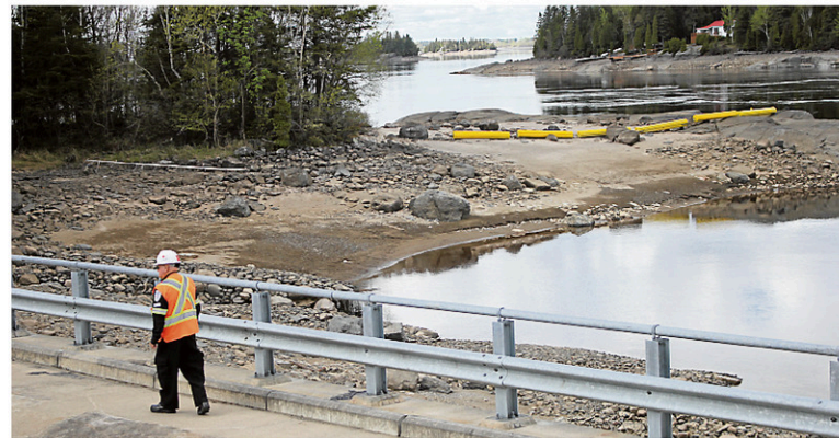
Près des ouvrages de Rio Tinto, des agents de sécurité veillent au grain. En jaune, à l'arrière, on aperçoit une estacade qui n'a pas encore été installée. — PHOTO LE QUOTIDIEN, ISABELLE TREMBLAY
