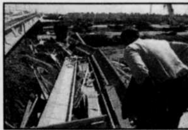
Les problèmes signalés aux autorités de Laval sont courants sur ce genre de chantier et ont été corrigés, assure le maire Vaillancourt.
