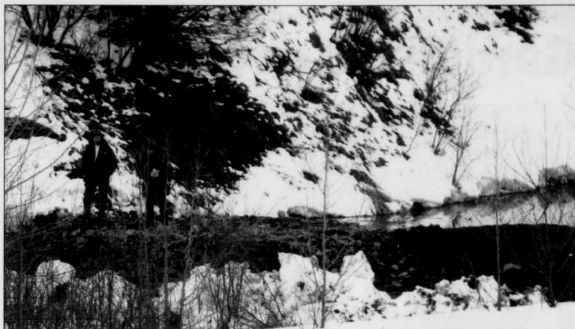
DIGUES - Des digues ont été construites vendredi soir et hier matin pour retenir et filtrer les eaux remplies de boues rouges qui s'écoulaient vers le Saguenay par le ruisseau du Capitaine.
