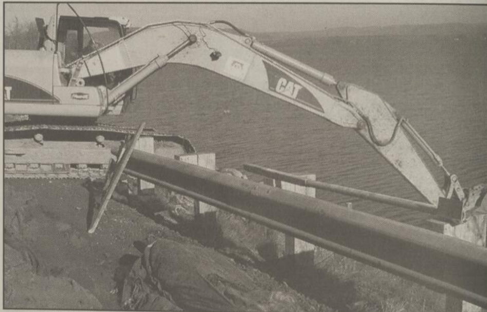
DANS UNE position assez audacieuse, cette machine de la firme Majeau procédait, mercredi, aux travaux de finition.
