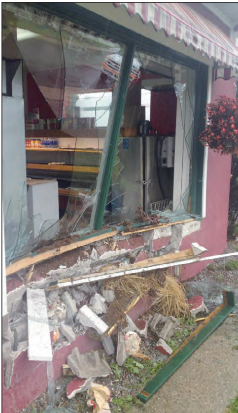
La vitrine a été complètement détruite. Les dommages sont évalués à plusieurs milliers de dollars.
