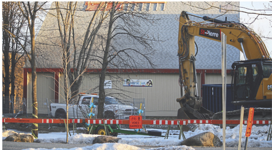
La démolition n'était toujours pas commencée lors du passage du Sherbrooke.info mercredi matin. Le bâtiment devrait être détruit d'ici jeudi. (Photo Sherbrooke.info - Marc-André Fortin)
