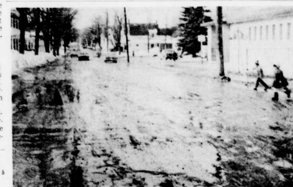
VERITABLE MER DE BOUE — C'est en une véritable mer de boue que s'est transformée la rue St-Patrice à Magog, avec les derniers changements de température et les dégels. Par suite de travaux d'aqueduc effectués l'automne dernier, l'asphalte a été enlevée et les automobilistes devront redoubler de prudence et patienter jusqu'à ce que la température permette aux employés municipaux d'effectuer des travaux de pavage.
