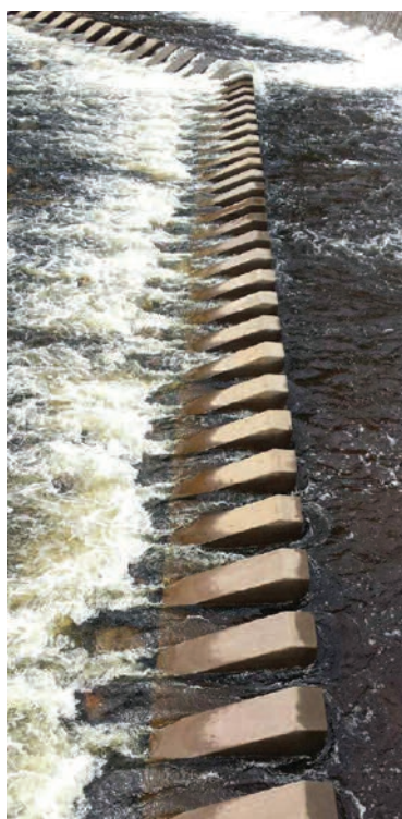
La structure qui poserait problème.
