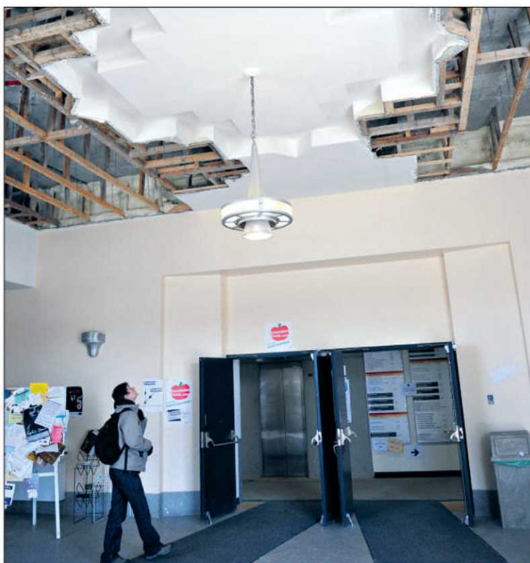
L'eau du toit s'est accumulée sur le plafond en gypse qui a fini par céder, au-dessus de l'entrée principale, mardi après-midi. Personne n'a été blessé.
